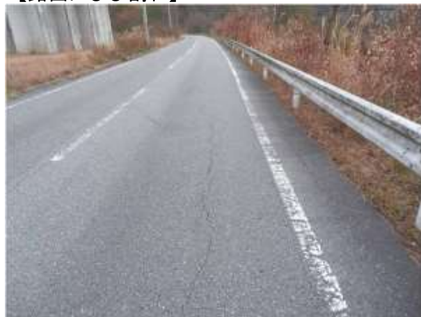
●車上からの異常(気づき) 【路面にひび割れ】
