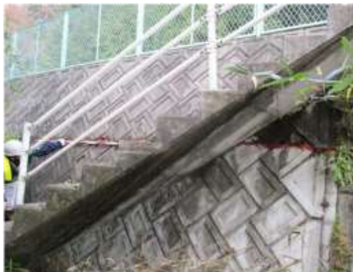
【水平方向のひび割れ】近景
