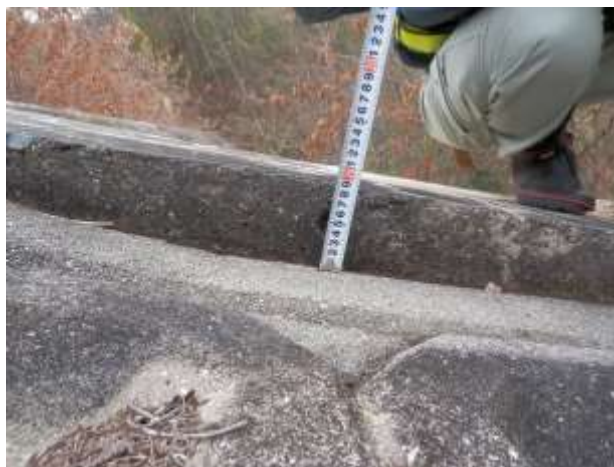
③ 目地の異常(目地のずれ、段差)
