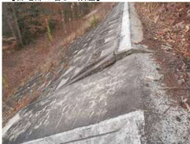
●ブロック張の目地部段差 【目地部の著しい段差】
