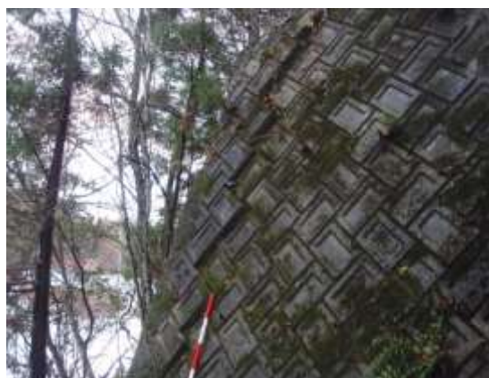
【ひび割れ、はらみだし】
