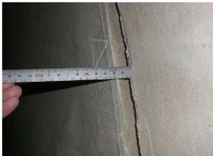
付写真-1.4.4 段差の例
