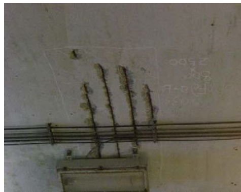
付写真-2.1.2 鋼材腐食の例
